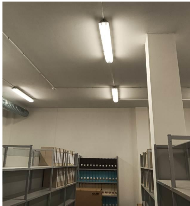
Obr. 2. Elektrické osvětlení spisovny
