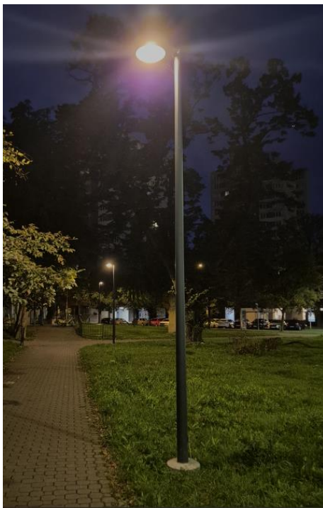
Obr.10 (Nový stav – VO během provozu)
