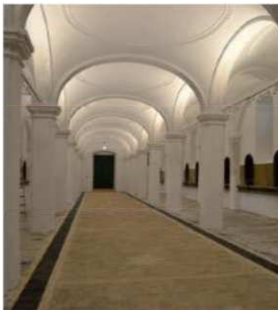
Obrázek 6 – Zámecká jízdárna – lištový systém osvětlení
