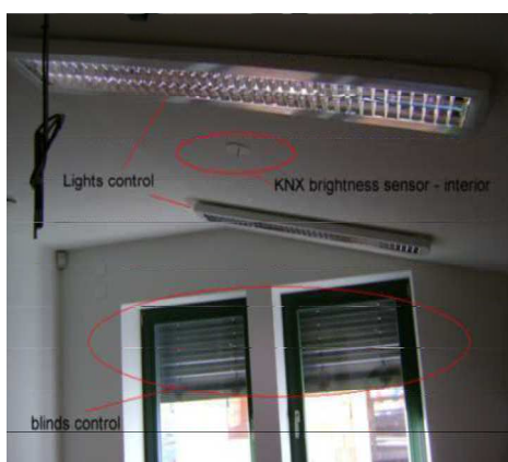
Obr. 4. Příklad provedení řízení osvětlení a žaluzií pomocí systému KNX ve vybrané místnosti dřevodomku.
